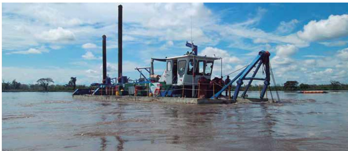
Imagen: Mantenimiento del canal navegable mediante dragado hidráulico en el río Magdalena en el sector comprendido entre Puerto Salgar/ La Dorada (Cundinamarca/Caldas) – Barrancabermeja (Santander).” Utilizando las dragas de corte Río Magdalena y Don David, draga de succión en marcha Mahury. Tomado de: http://www.dragadoshidraulicos.com/index.php/proyectos/realizados/76-rio-magdalena
